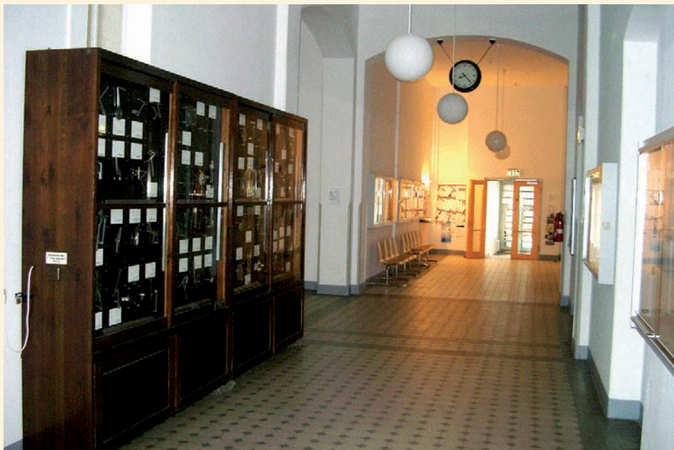
Abb. 1: Notwendiger Flur in einem Hochschulgebäude mit zunächst unzulässigen Brandlasten im notwendigen Flur. Im Rahmen einer Gefahrenanalyse sind das tatsächliche Risiko und die möglichen Kompensationsmaßnahmen festzustellen.
